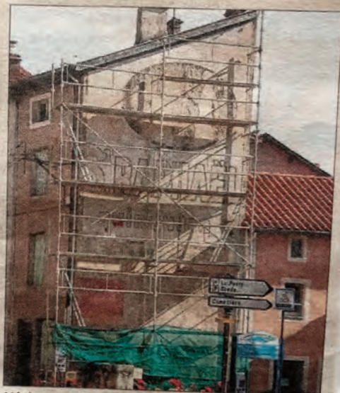
L'échafaudage attend l'artiste pour le début de la rénovation. Photo Progrès/David LUMINIER
